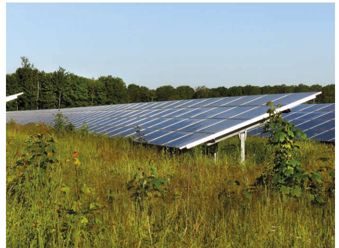
Freiflächen-Photovoltaik-Anlage bei Geseke, NRW. (Foto: Ralf Joest)
